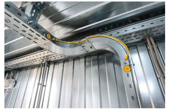
Верхняя разводка кабелей в гофрированных трубах - в подвесных металлических коробах (подвесные системы ДКС, Италия)
