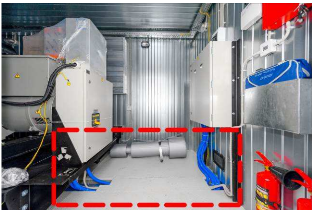
В полу контейнера расположена скрытая магистраль для прокладки силовых кабелей и прочей электроразводки
