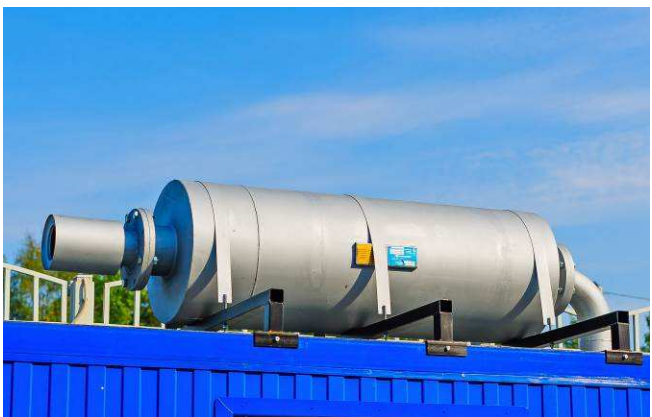
Промышленный глушитель с искрогасителем на крыше контейнера
