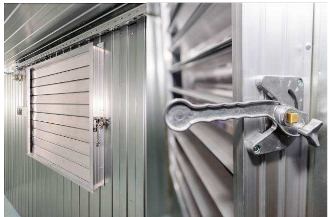
Внутри – клапаны притока-оттока воздуха с ручным приводом
