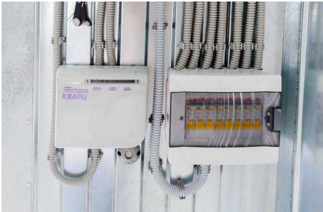
Система пожарной/охранной сигнализации на базе прибора «Кварц» и щит собственных нужд контейнера (ЩСН)
