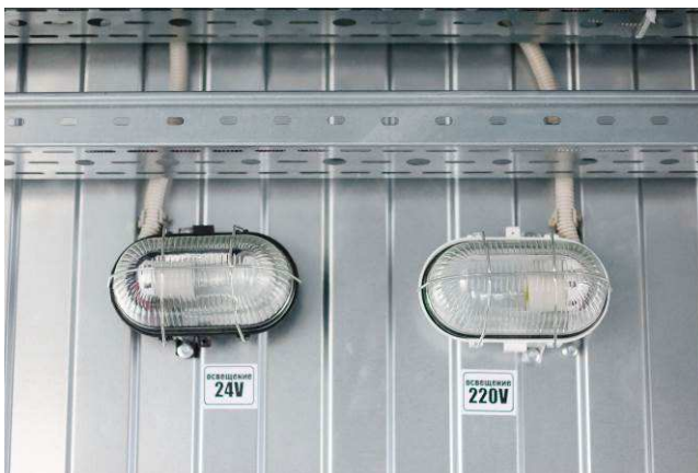
Система основного и резервного освещения
